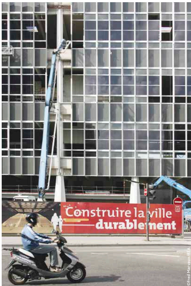
Reconversion de l'ancien Tri postal de Nancy (Claude Prouvé, arch.) en Centre de congrès (Atelier Marc Barani, arch ; Atelier Christophe Presle, arch. ass.)
